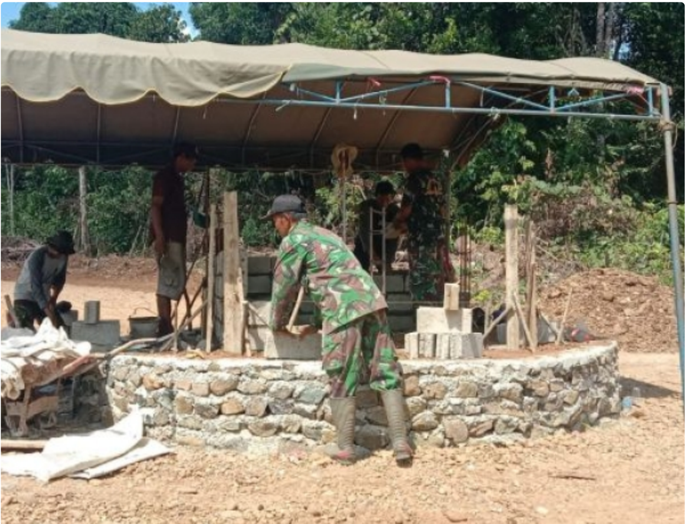
Satgas TMMD ke-113 Kodim 1006/Banjar Bangun Tugu Bundaran Penghubung Tiga Desa Banua Riam
